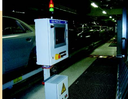
Integration der Bedienpulte mit Panels TP151 in der Förderanlage der Lackiererei
